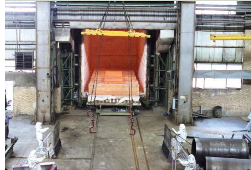
▲ کوره های عملیات حرارتی
