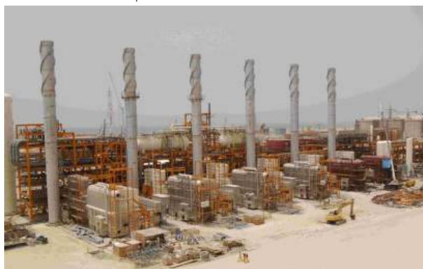
▲ بویلرهای پارس جنوبی فاز ۲۴-۲۲ ۶×۱۶۵t/h
